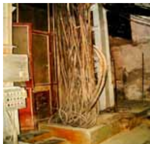
Sl. 8: Npropisno vođenje kablova
