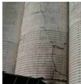
Sl. 4: Čelija silosa posle požara
